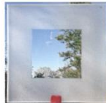
・ガラス白濁例(外枠)
